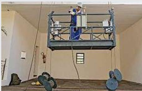
Figura 2: Dispositivo móvel para apoio na manutenção de fachadas
